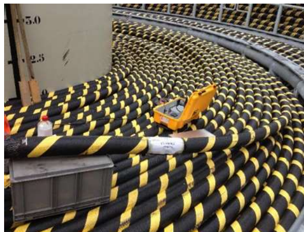
Monitoraggio del cavo di potere
