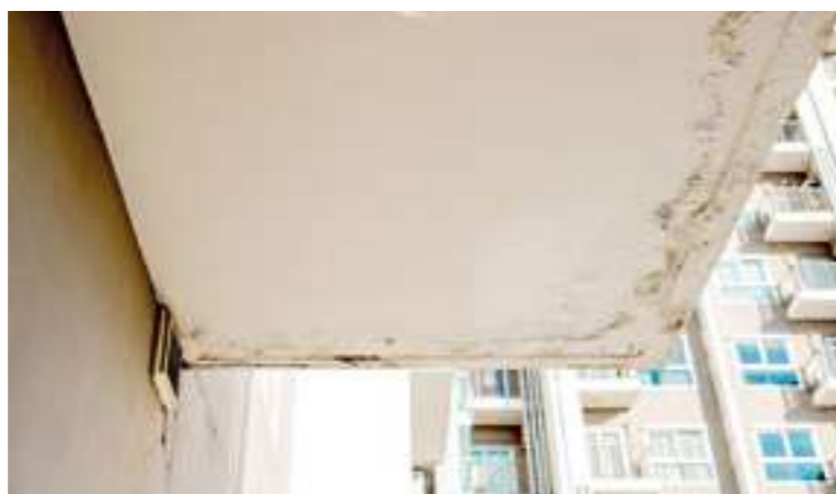
Infiltrazioni in balcone
