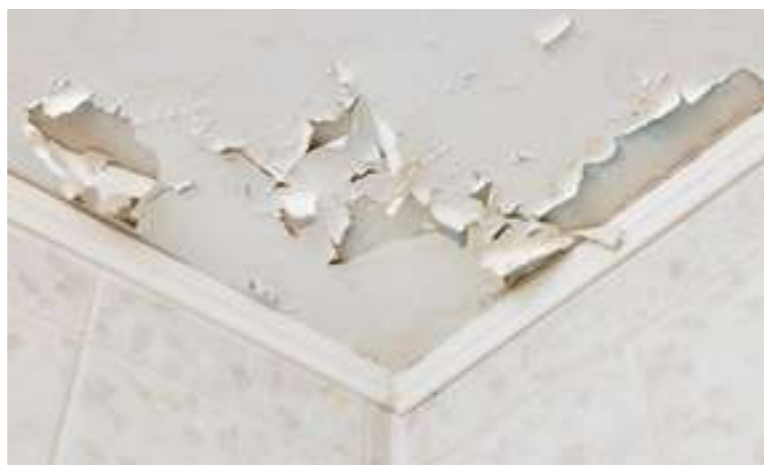
Infiltrazioni in casa
