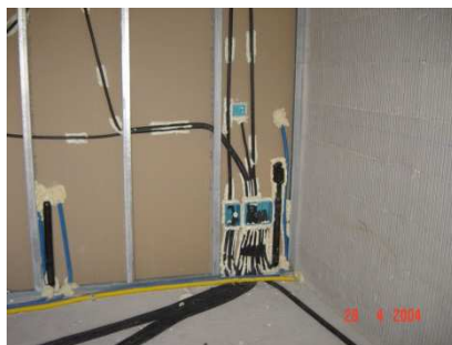
Scatole di derivazione impianto elettrico su parete in cartongesso
