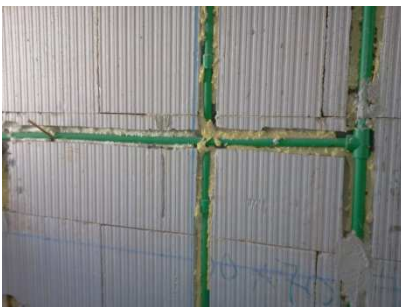
Tracce su isolamento interno
