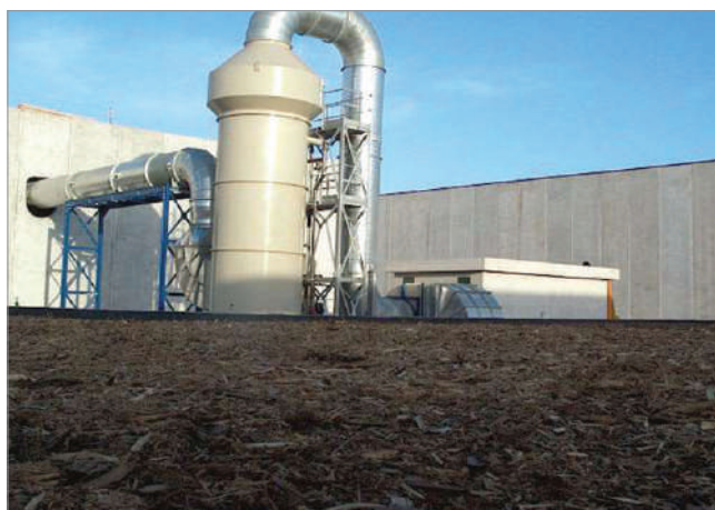
Impianto di compostaggio
