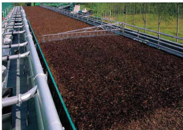
Impianto di biofiltrazione
