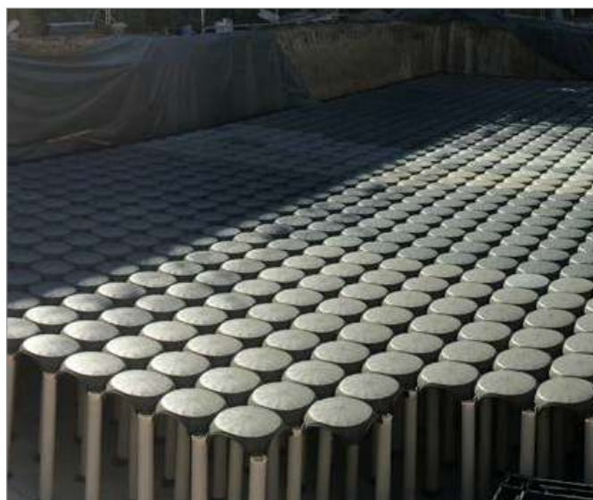
Uppsamlingsstank för regnvatten
