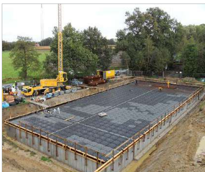
Uppsamlingskammare för regnvatten
