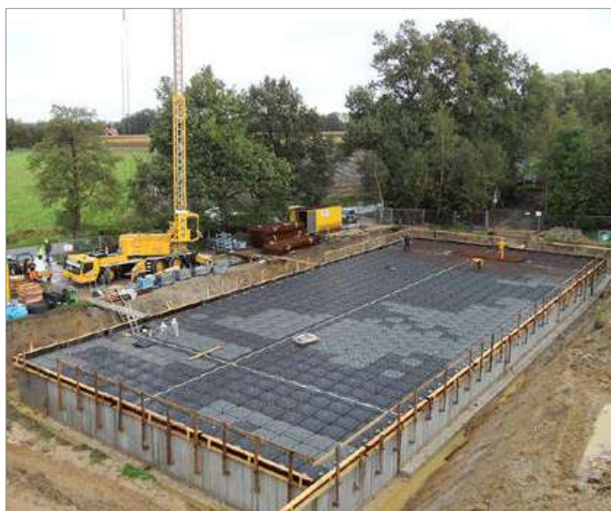
Tanque de recolha de água da chuva
