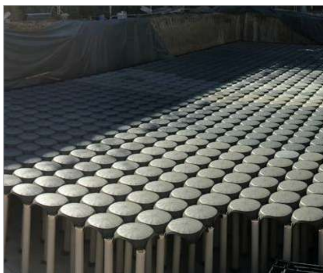
Tanque de recolha de água da chuva
