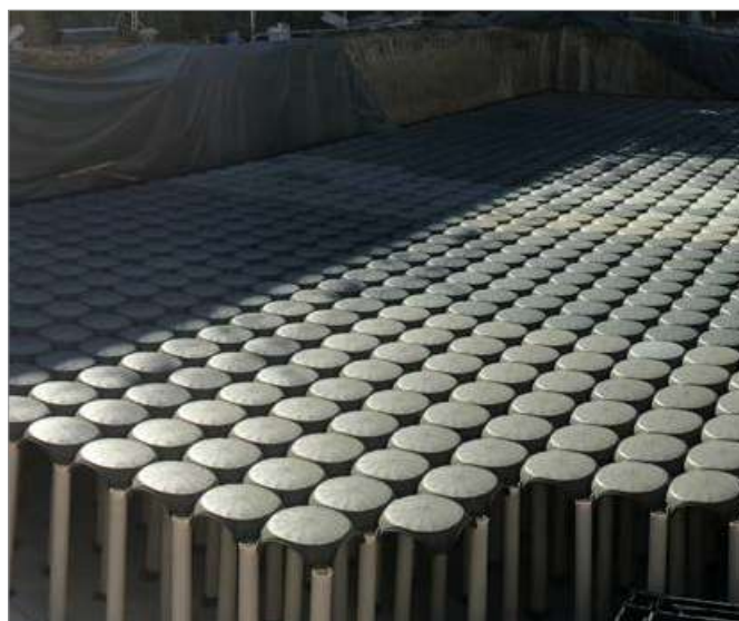
Cisterna para la recogida de agua
