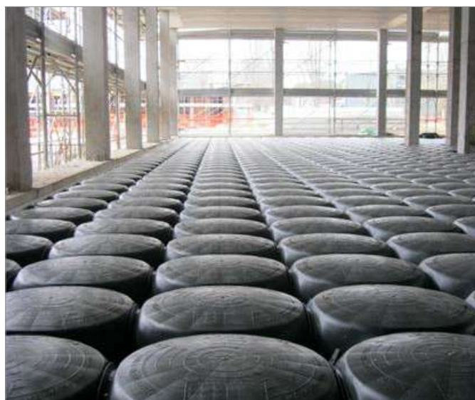
Belüftungshohlraum für Sanitärgebäude
