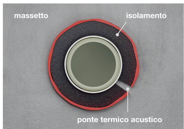
Fig 37: Trasmissione del rumore strutturale causato da un isolamento non conforme.
