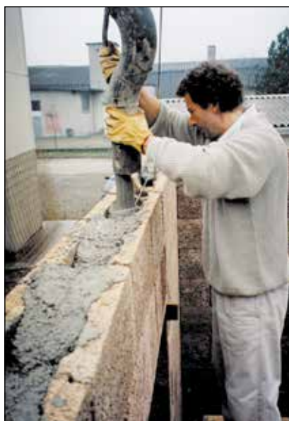
Ogni 6 corsi in altezza viene fatto il getto in calcestruzzo, che deve essere vibrato.
