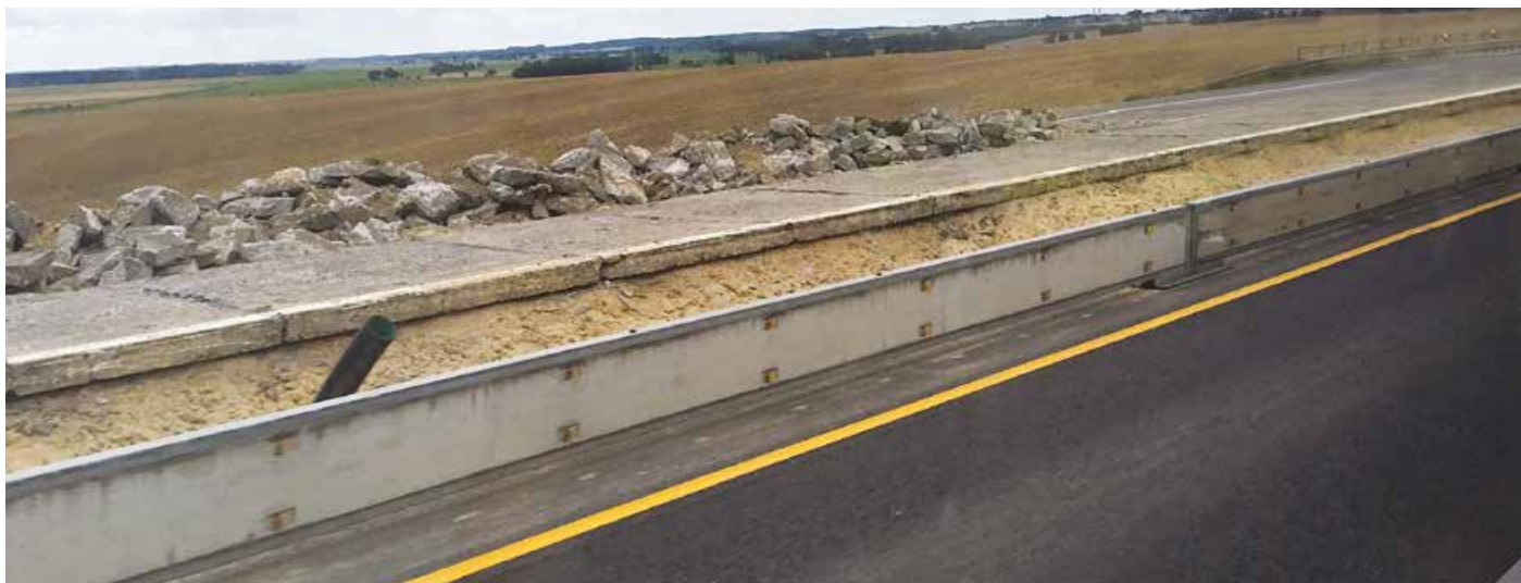
Tipico esempio di manto stradale in calcestruzzo in fase di demolizione a causa di problemi di sconnesione facilmente risolvibili con TRACK PILE®.
