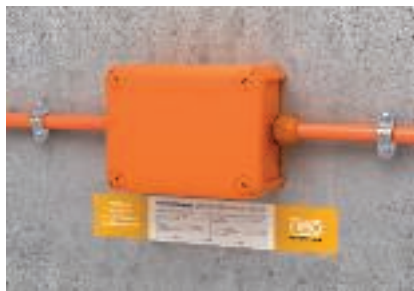
Scatola FireBox installata con etichetta di contrassegno
