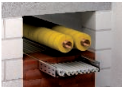
Tubi non ininfiammabili con isolamento
