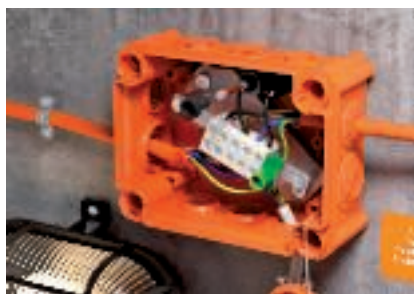
Ingresso cavi con passacavi morbidi
